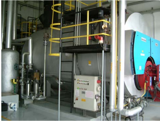
广州百特医疗用品有限公司：低压蒸汽锅炉
