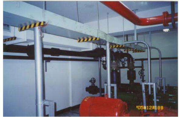
安装于水箱供水管
