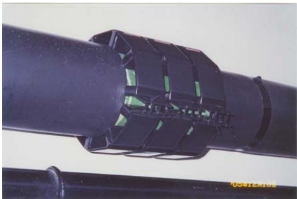
安装于水箱供水管(M-6Tri/S)
