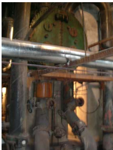
应用于电厂热交换器
