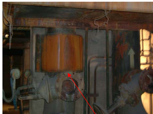
安装于热交换器冷却水进水管(M-16) [用红色铁皮包裹保护]
