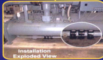
空调、冷冻机组增能系统
